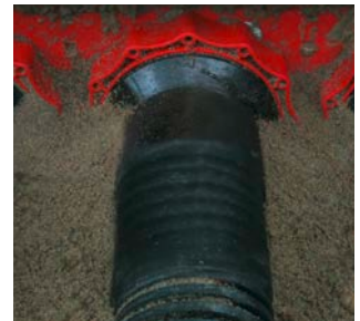
Wellrohranschluss mit Kaltschrumpftechnik HSI 150-D 110-KS
